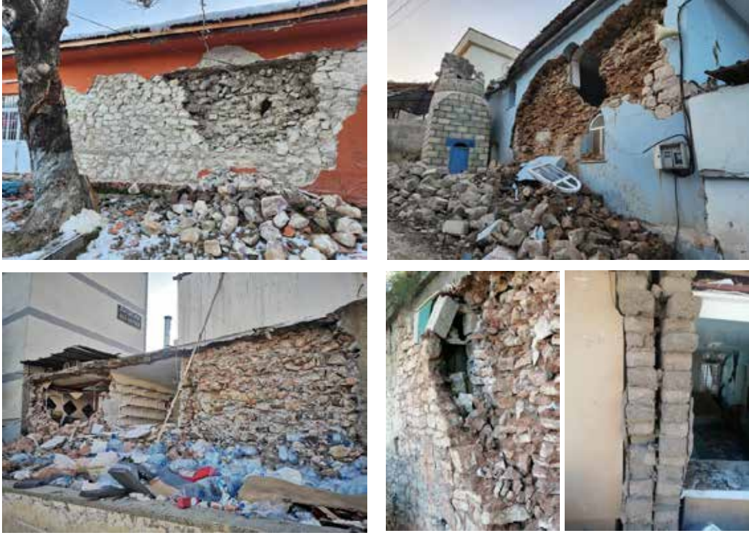
Şekil 96. Duvar katmanları arasındaki bağlantı eksikliğinden kaynaklı hasarlar (Gaziantep İli, İslahiye İlçesi ve Kahramanmaraş İli)
