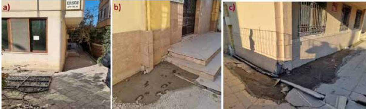
Şekil 60. Hatay İskenderun'da sıvılaşma nedeni ile kum çıkışları ve yapı oturmaları
