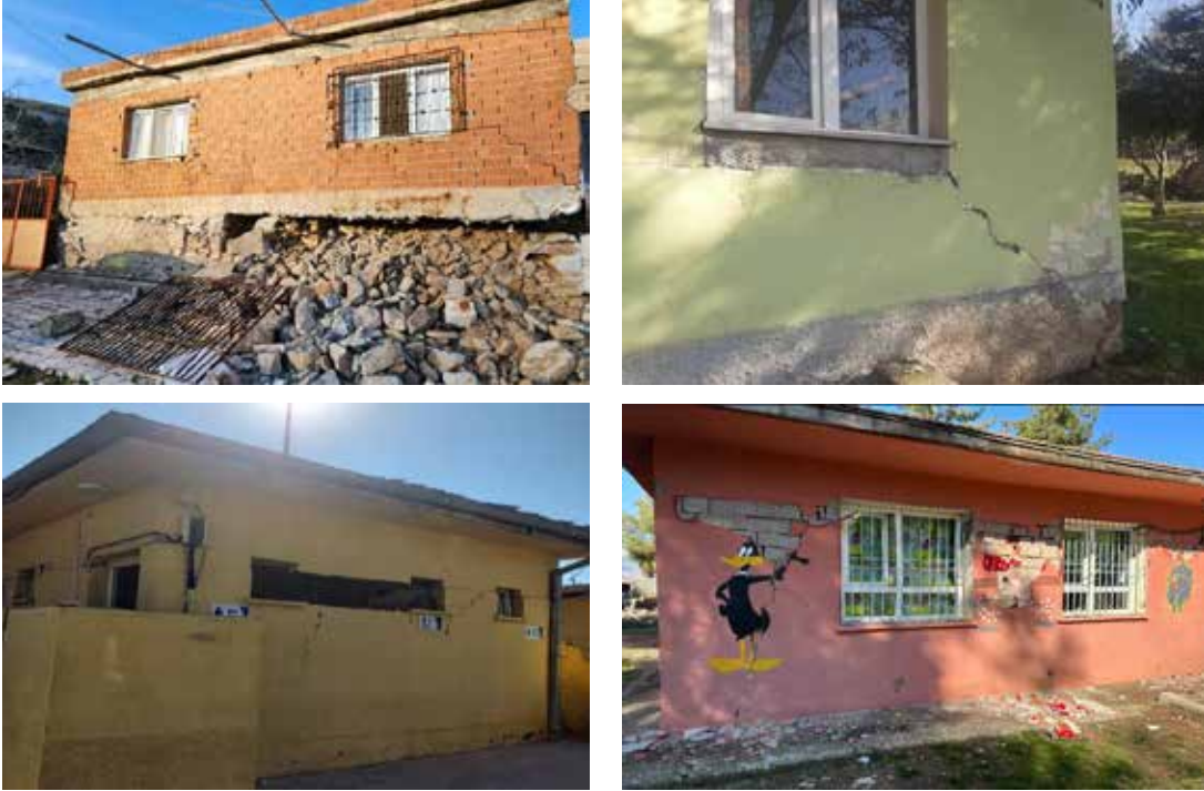
Şekil 89. Bazı yığma binalarda düzlem içi kuvvetlerden kaynaklı gelişen diyagonal çekme çatlakları (Gaziantep İli İslahiye İlçesi ve Hatay İli)
