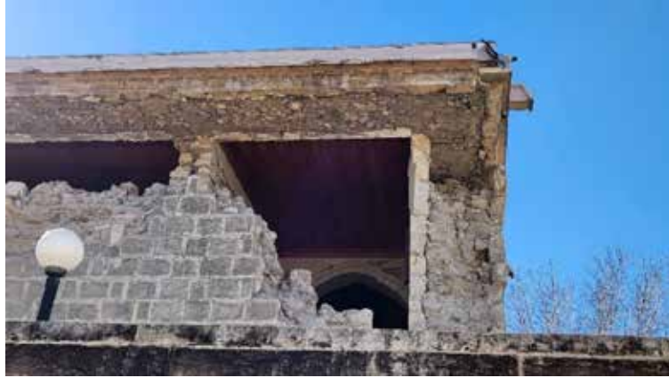
Şekil 132. Düzlem dışı etkilerden kaynaklı taşıyıcı duvarlarda oluşan hasarlar
