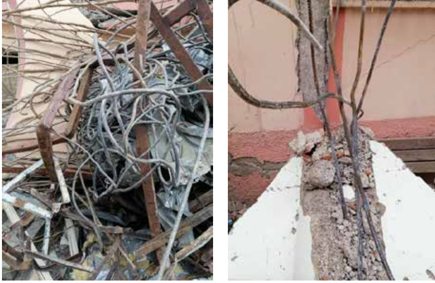
Şekil 175. Betonarme camilerde gözlemlenen nervürsüz donatılar
