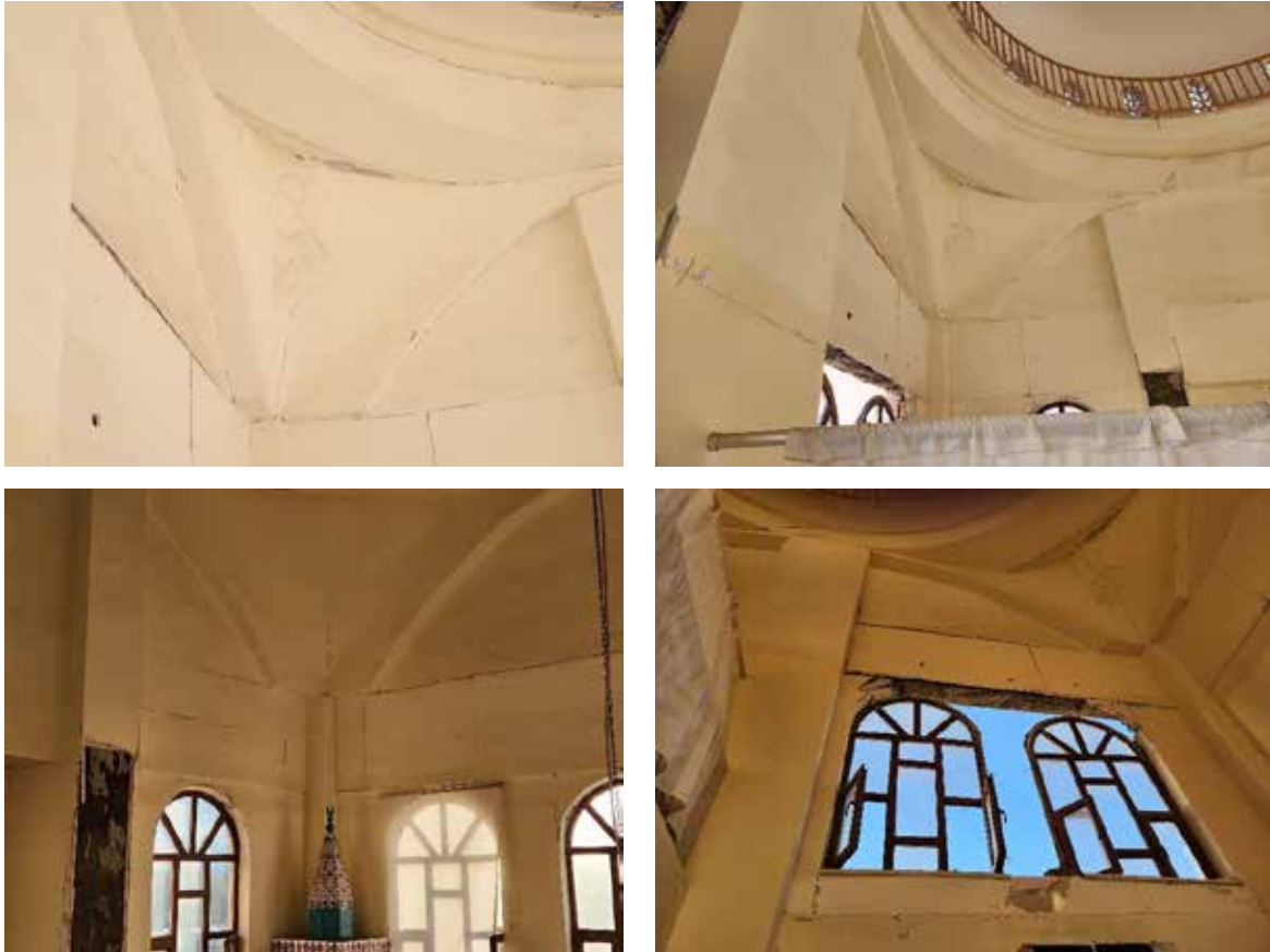
Şekil 170. Betonarme camilerde gözlemlenen pandantif hasarları
