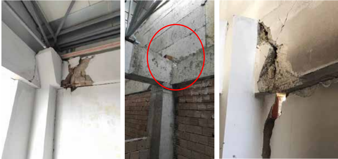
Şekil 106. Kolon-kiriş birleşim bölgesinde kiriş hasarları (Kahramanmaraş)
