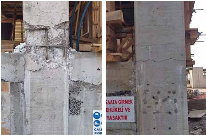
Şekil 108. Kısa kolon hasarları ve dilatasyon derzi yokluğu (Kahramanmaraş)
