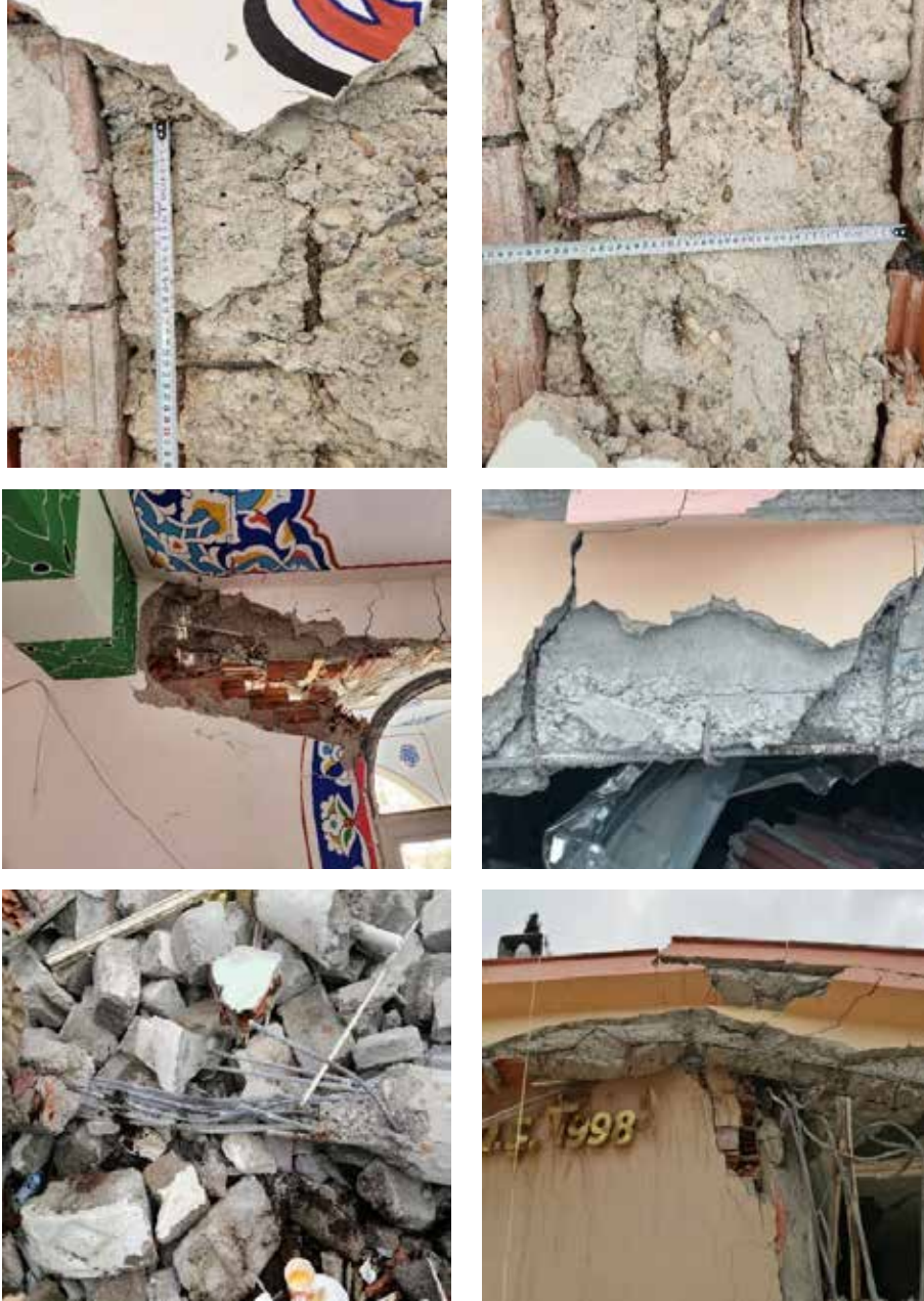
Şekil 174. Betonarme camilerde gözlemlenen donatı detay hataları
