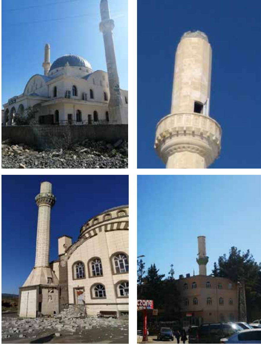
Şekil 183. Betonarme minarenin petek ile külah arasındaki hasarlar
