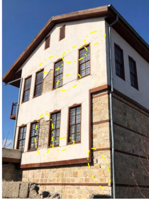
Şekil 158. Bağdadi duvarlarda sıva dökülmeleri ve düzlem içi etkilerden kaynaklı çatlaklar
