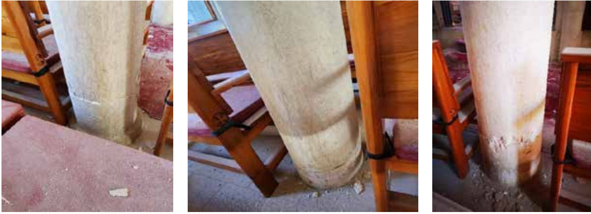
Şekil 133. Sütunlarda tespit edilen hasarlar
