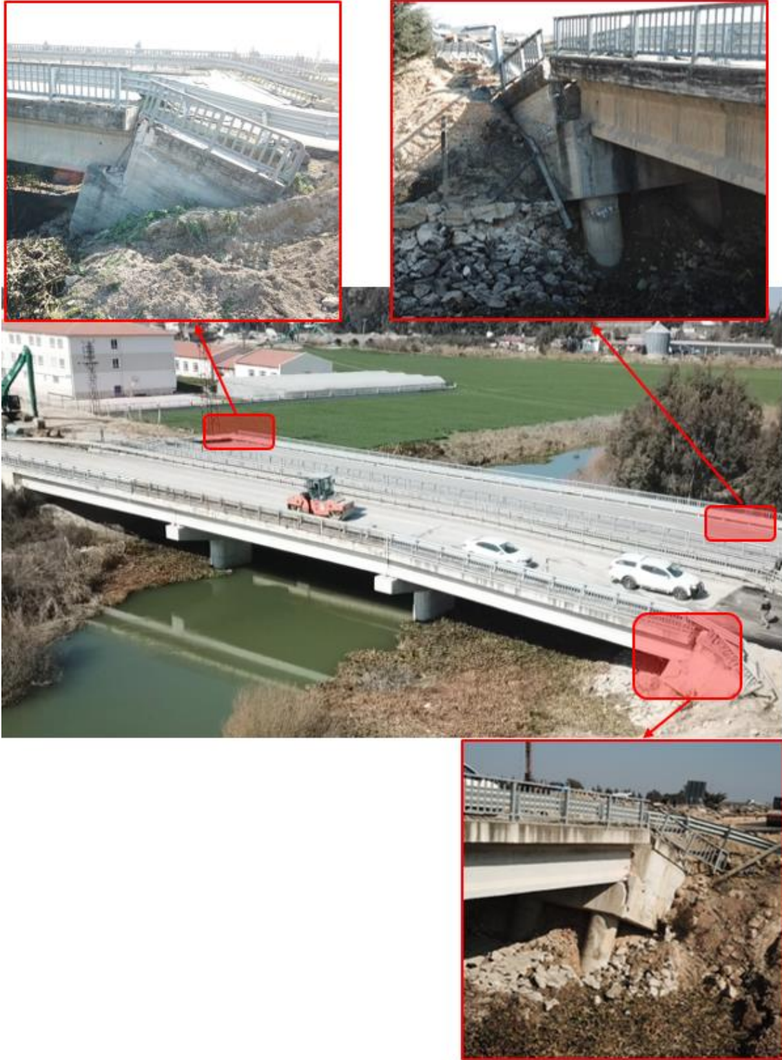
Şekil 116. Sıvılaşma ve kenar ayak dönmesi nedeniyle köprülerde oluşan hasarlara ait bazı örnekler
