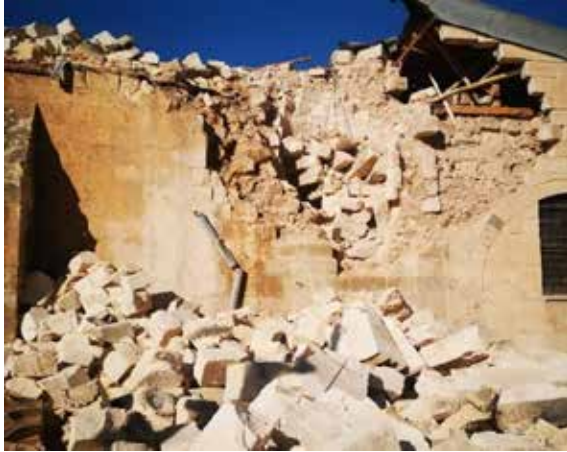
Şekil 178. Yığma cami taşıyıcı duvarlarında oluşan hasarlar
