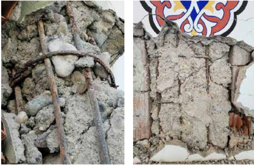
Şekil 176. Betonarme camilerde gözlemlenen yetersiz beton kalitesi
