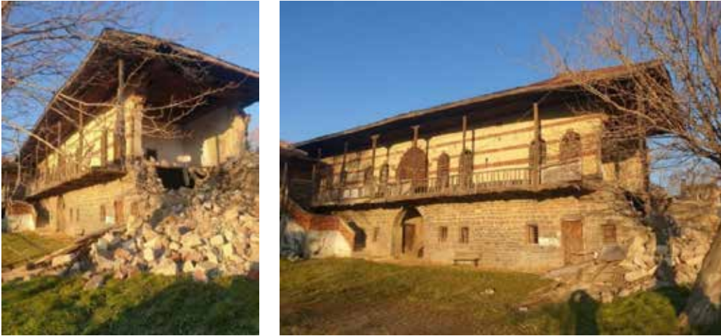
Şekil 155. Düzlem dışı etkilerden kaynaklı göçme
