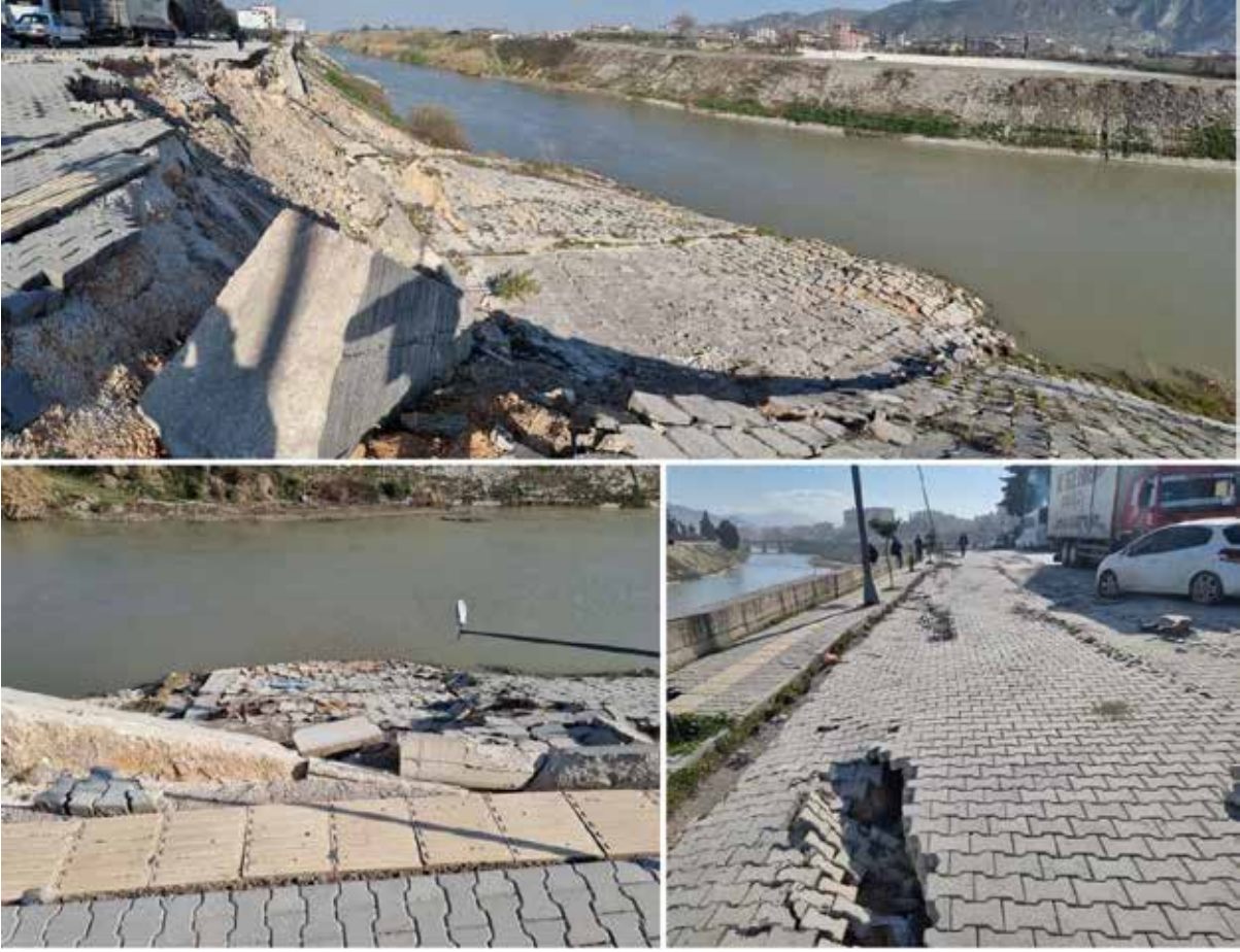
Şekil 64. Hatay Altınözü Tepehan Mahallesi'nde oluşan kitle hareketi
