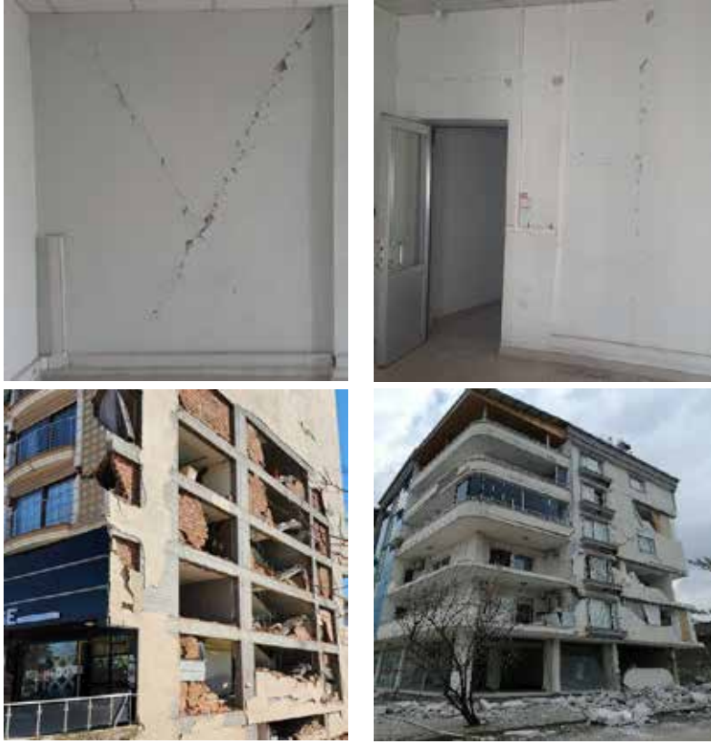
Şekil 69. Zayıf dolgu duvar hasarları
