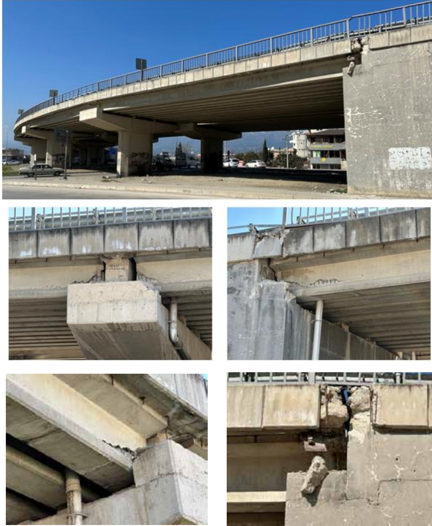
Şekil 115. Çekiçleme ve prekast kirişleri nedeniyle köprülerde oluşan hasarlara ait bazı örnekler
