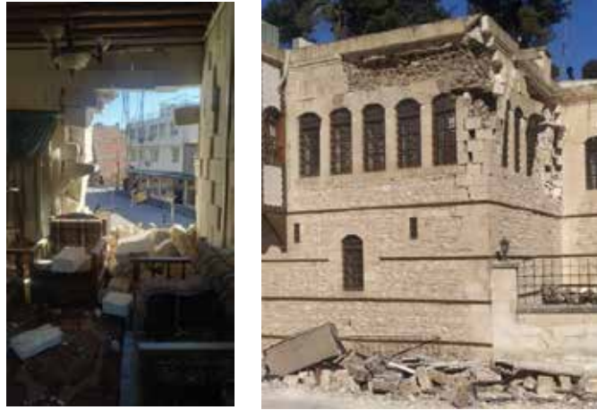
Şekil 157. Düzlem dışı etkilerden kaynaklı hasar ve göçmeler
