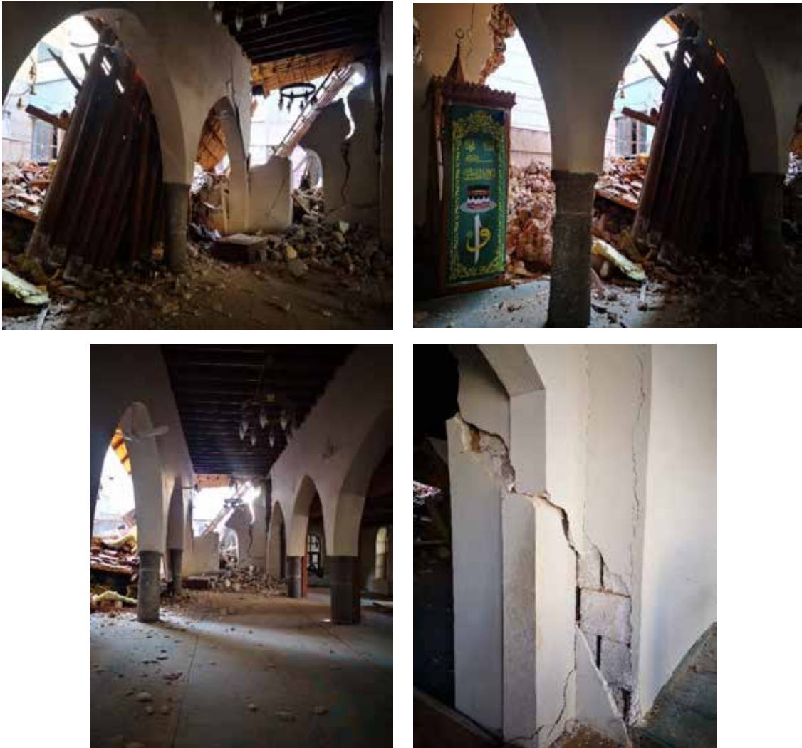
Şekil 151. Düzlem dışı etkilerden kaynaklı hasar ve göçmeler
