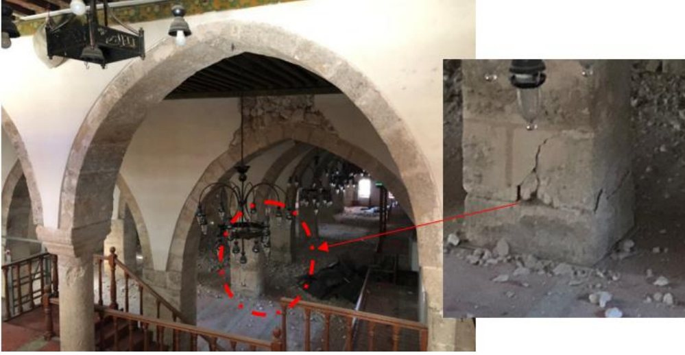
Şekil 154. Cami ayaklarında oluşan hasarlar
