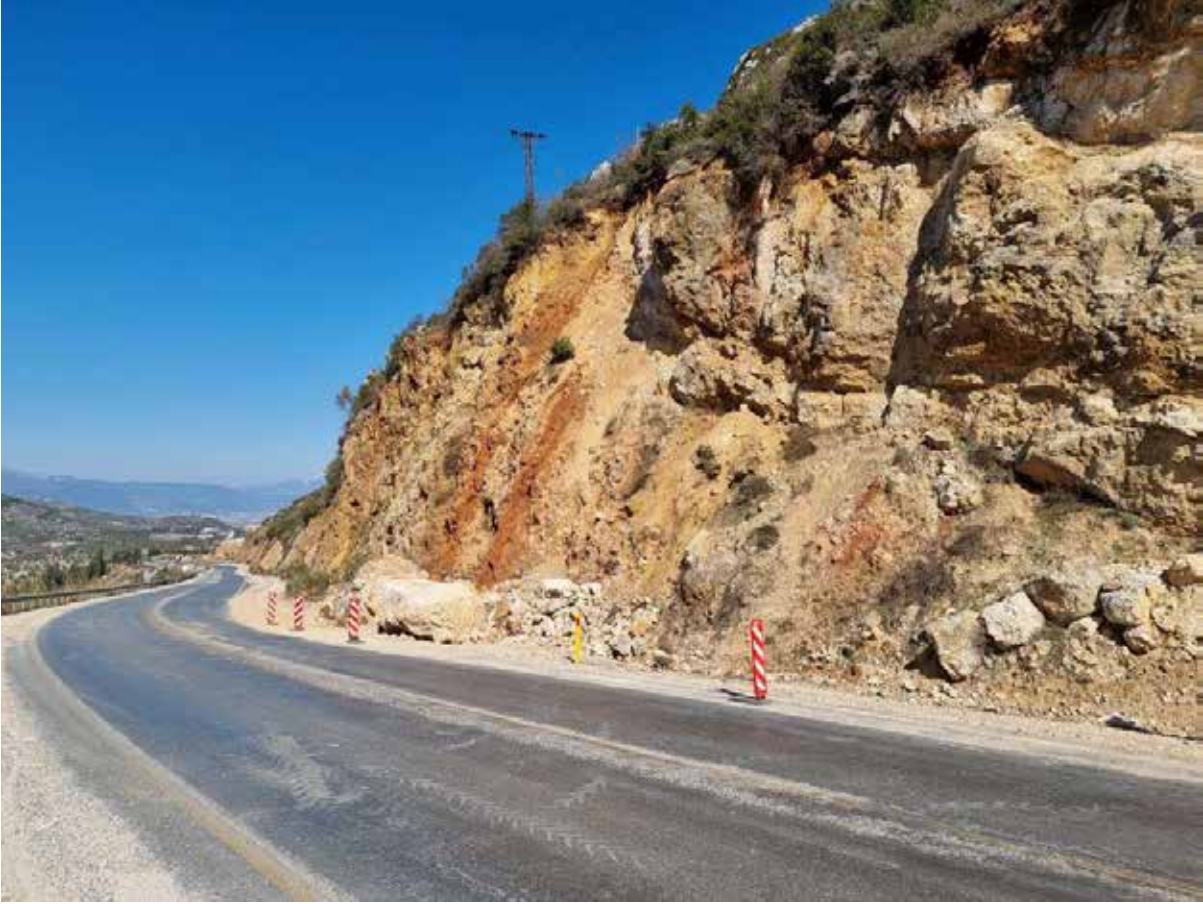
Şekil 62. Hatay Altınözü yolu üzerindeki kaya düşmesi
