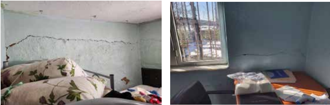
Şekil 90. Bazı yığma binalarda düzlem içi kuvvetlerden kaynaklı gelişen yatay kayma çatlakları (Gaziantep İli, İslahiye İlçesi)
