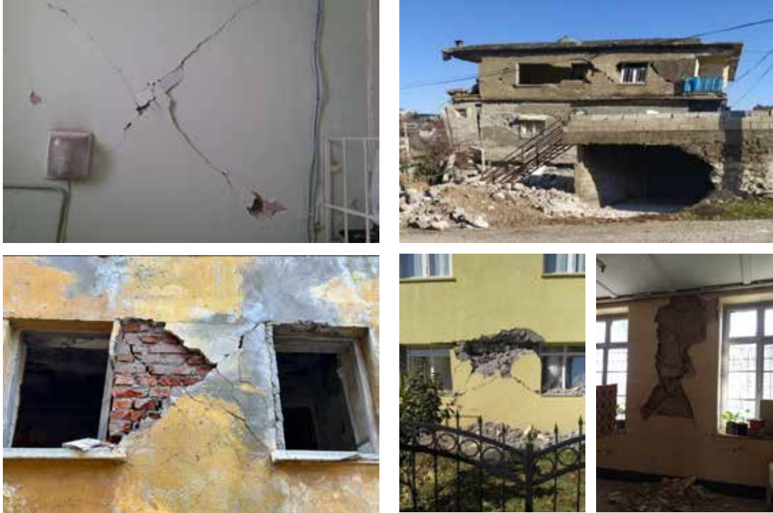
Şekil 88. Yığma duvarlarda kayma gerilmelerinden kaynaklı diyagonal çekme çatlakları (Gaziantep İli, İslahiye İlçesi ve Hatay İli)
