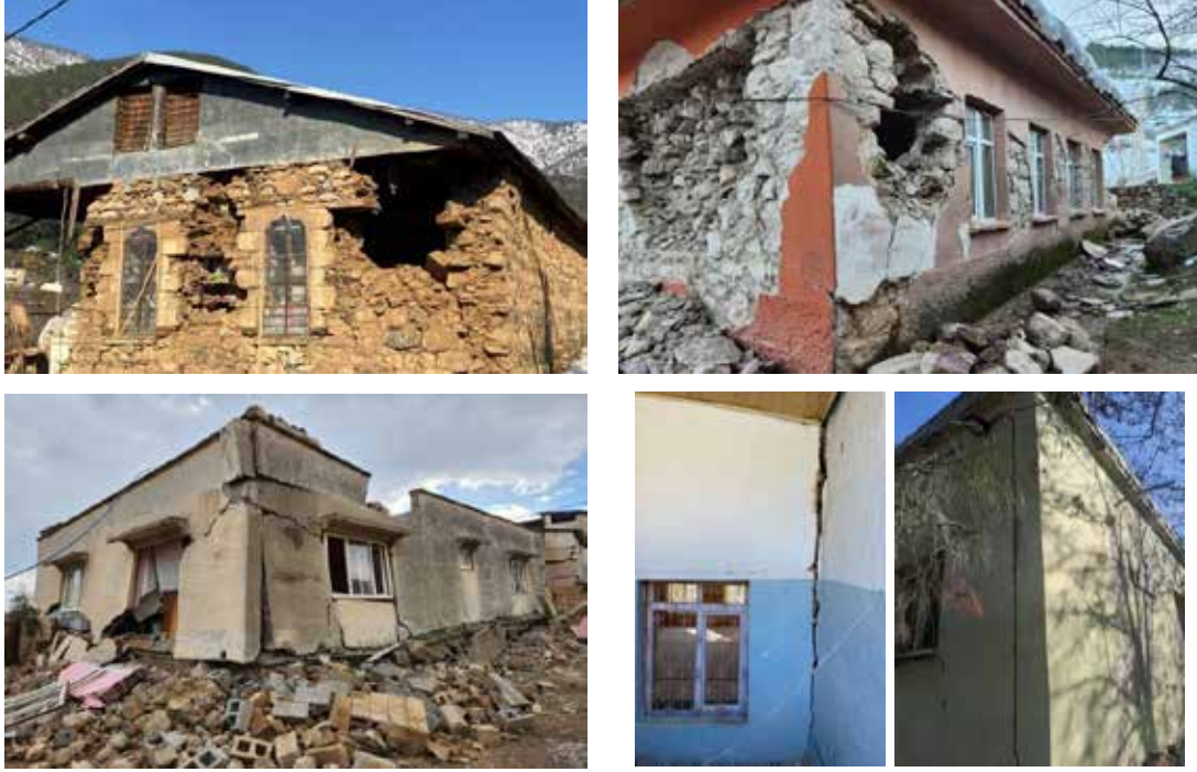
Şekil 94. Düzlem dışı kuvvetlerden kaynaklı bazı yığma binalarda meydana gelen köşe hasarları (Gaziantep İli, İslahiye İlçesi)
