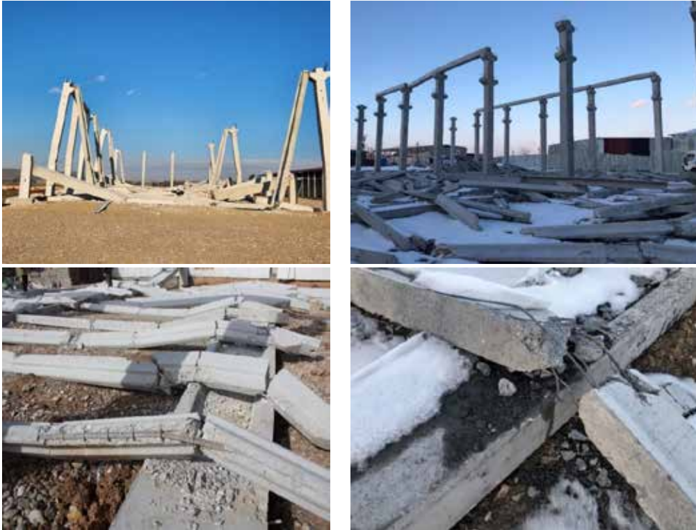
Şekil 109. Yapıdan ayrılan aşık kiriş hasarları
