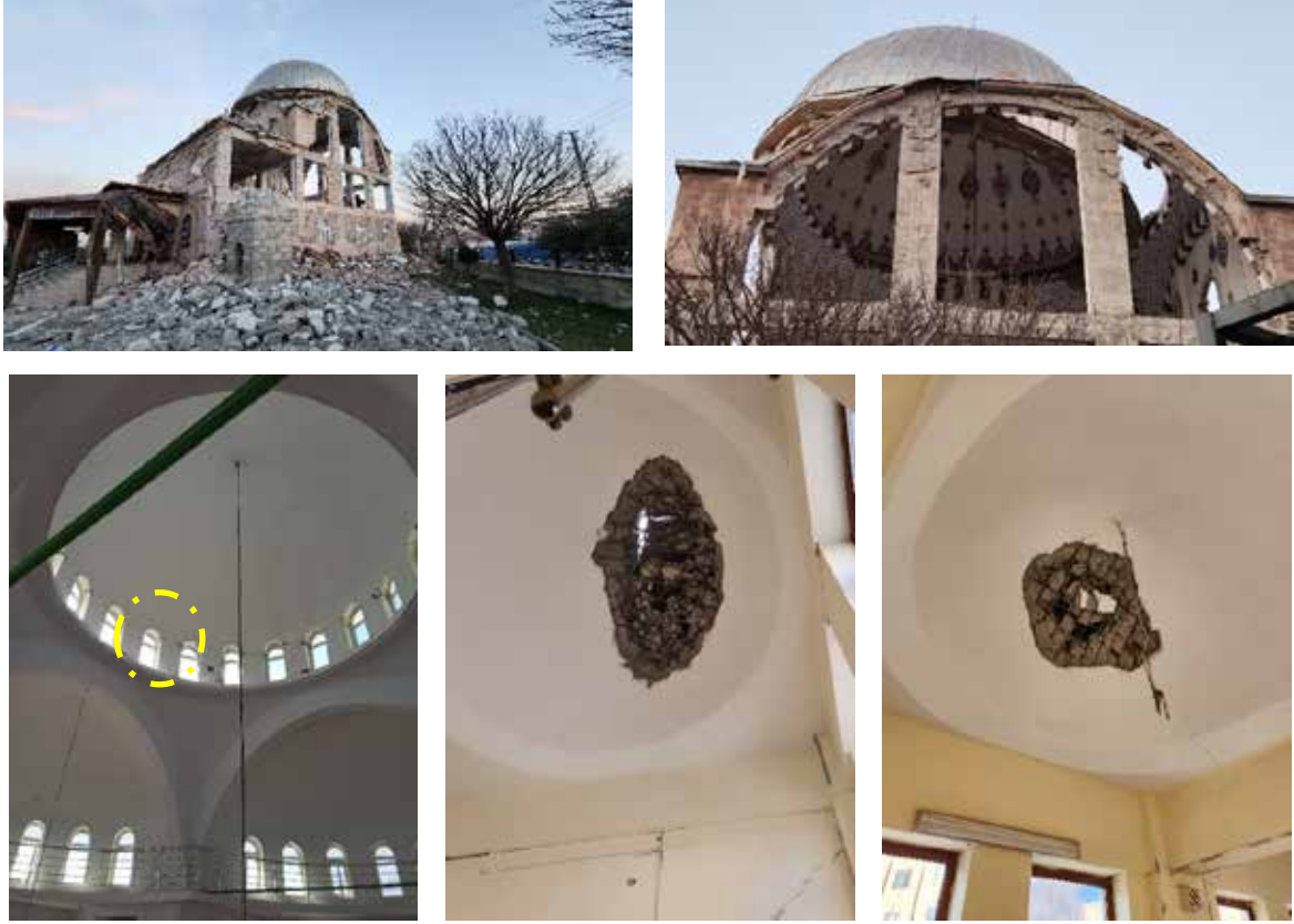
Şekil 169. Betonarme camilerde gözlemlenen kubbe hasarları
