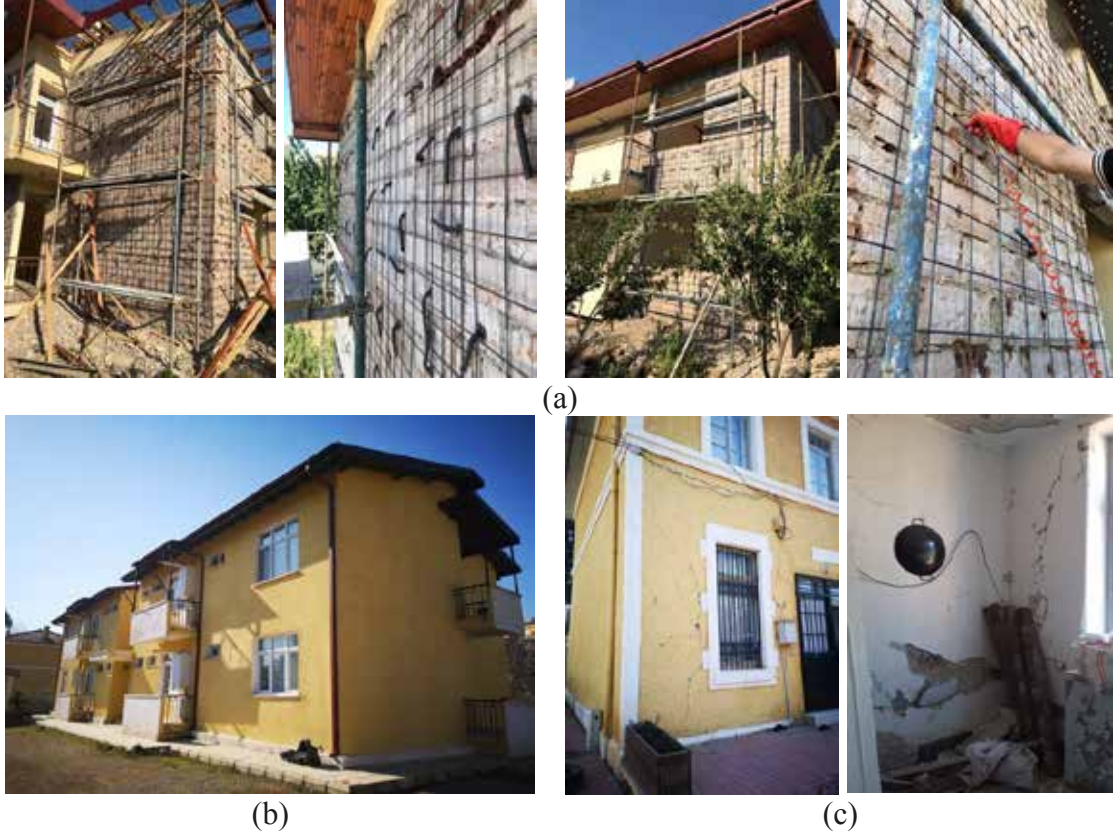
Şekil 98. Gaziantep İli, İslahiye İlçesinde çelik hasır donatı ve sıva ile güçlendirilmiş yığma bir binanın deprem performansı: (a) güçlendirme aşaması, (b) binanın deprem sonrası görünümü, (c) komşu yığma binada deprem hasarları
