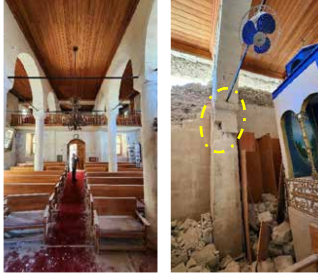
Şekil 136. Kemerlerde gerji elemanı kullanımı, kemerin oturduğu ayakta oluşan hasar
