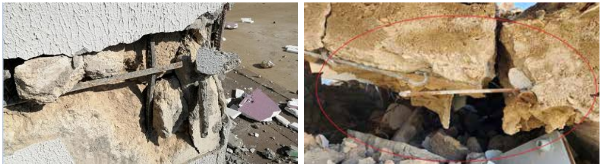
Şekil 70. Tespit edilen yetersiz donatı bindirme ve kenetlenme boyları
