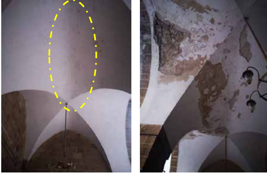
Şekil 145. Tonozlarda oluşan çatlak ve hasarlar
