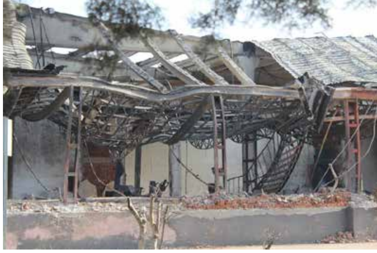
Şekil 101. Deprem sonrası ortaya çıkan yangın nedeni ile hasar gören yapı örneği
