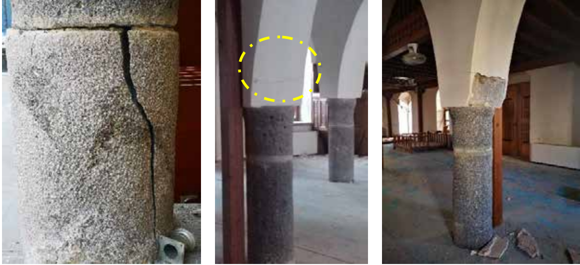
Şekil 150. Sütunlarda oluşan çatlak ve hasarlar
