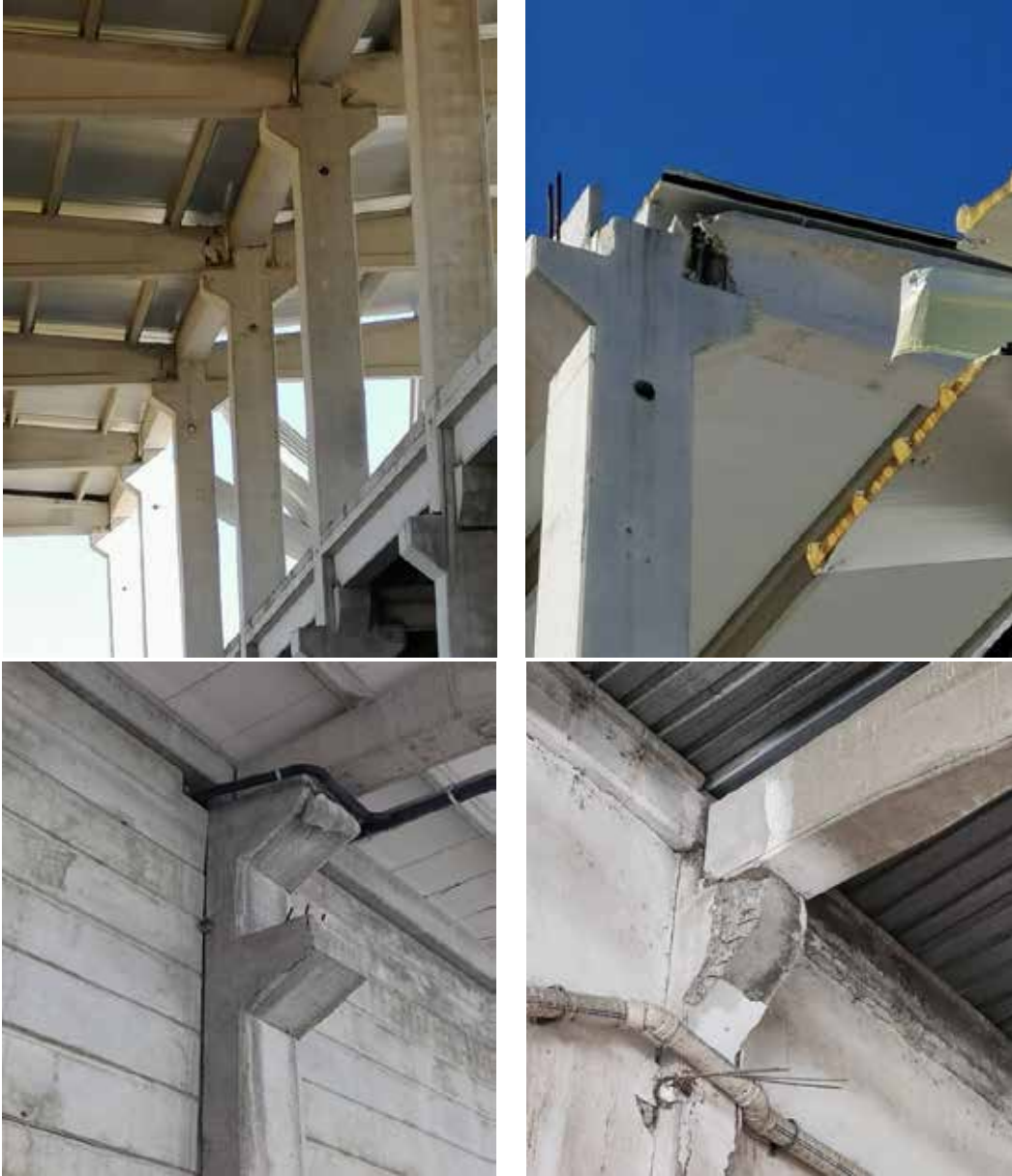
Şekil 111. Çatı kiriş ve konsol uç bölgesi hasarları
