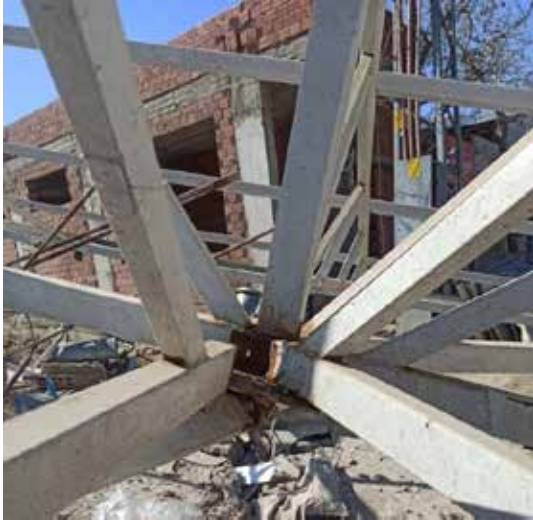
(b) Hatalı detaylandırma ve korozyon
