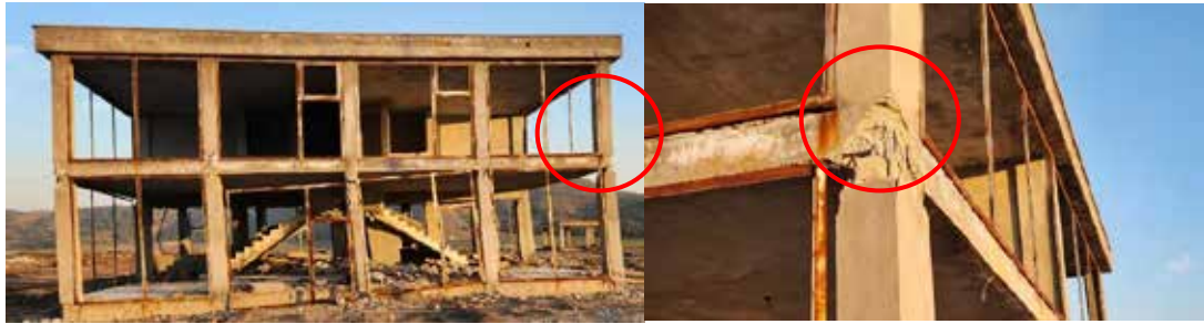
Şekil 107. Betonarme sanayi yapısı hasarları (Gaziantep Nurdağı)
