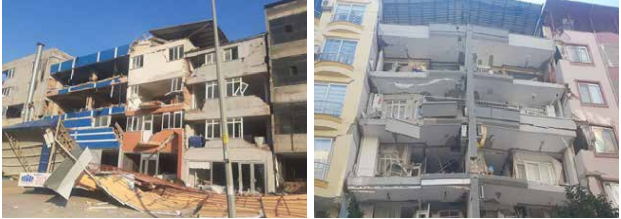
Şekil 71. Bitişik nizam yapılarda meydana gelen hasarlar
