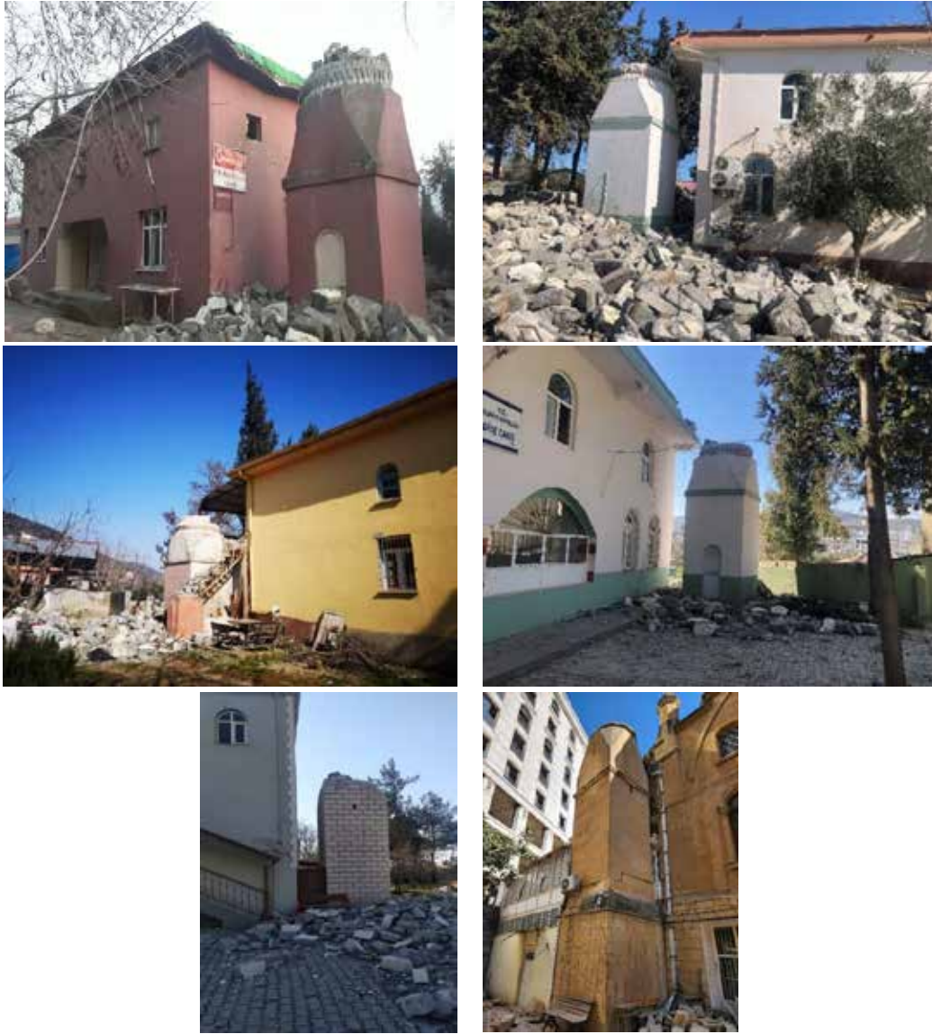
Şekil 186. Geçiş kesiti ile gövde arasında tespit edilen hasarlar
