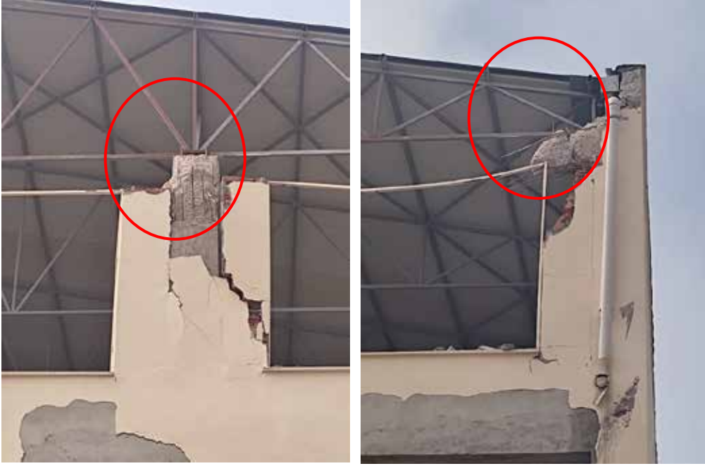
Şekil 105. Yetersiz birleşim sonucu ayrılan kiriş hasarı (Kahramanmaraş)
