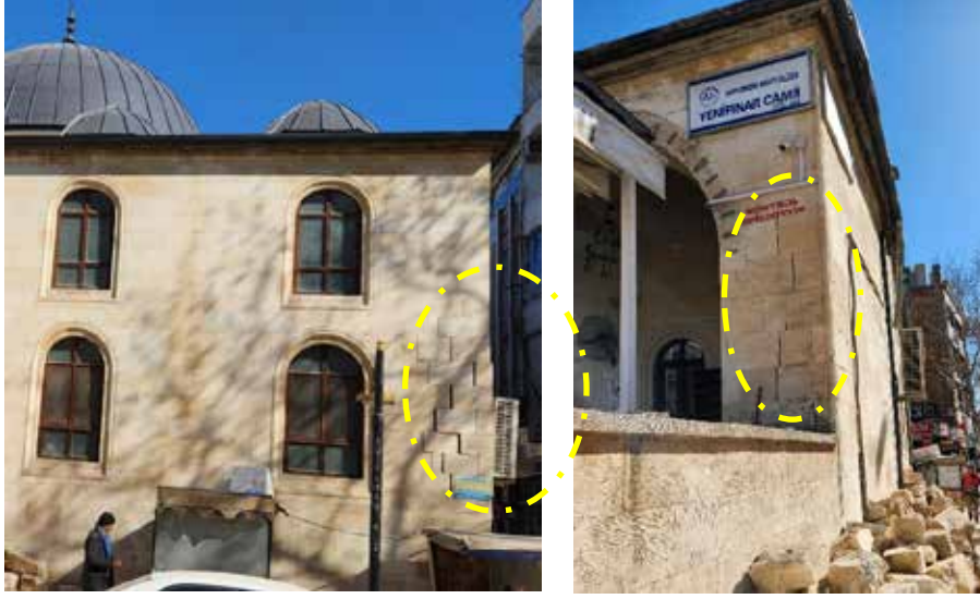
Şekil 142. Düzlem içi etkilerden kaynaklı diyagonal çekme çatlakları
