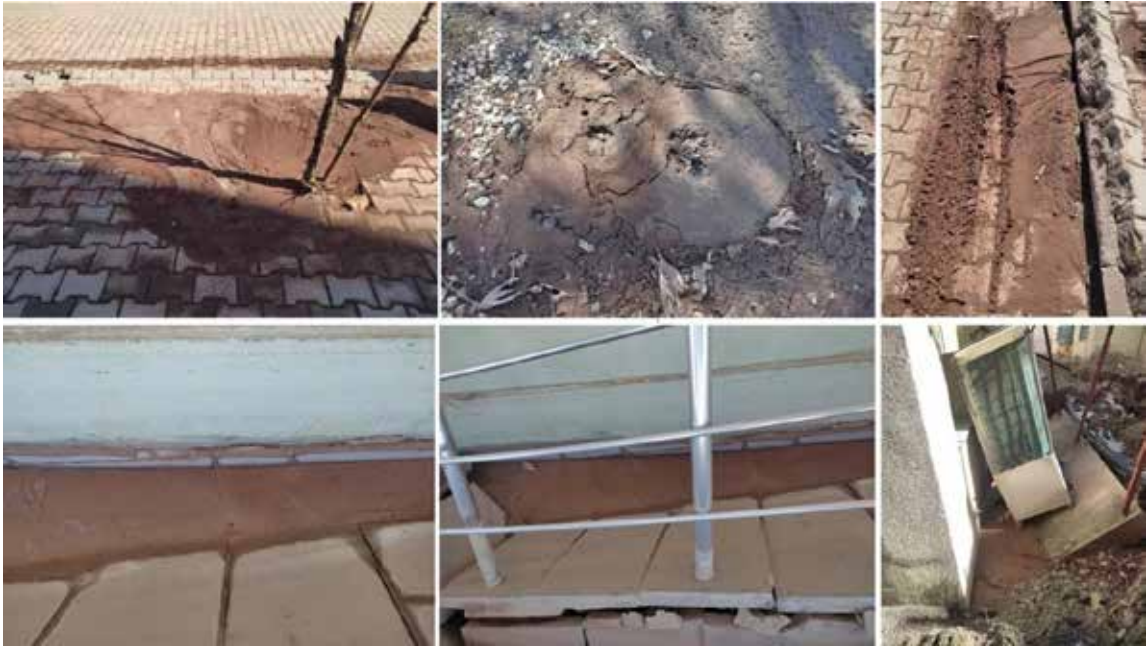
Şekil 55. Adıyaman Gölbaşı'nda sıvılaşma sonucu oluşan kum konileri
