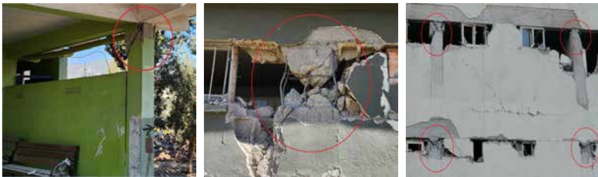
Şekil 65. Kahramanmaraş Pazarcık ve Elbistan Depremlerinde tespit edilen kısa kolon oluşumundan kaynaklı yapısal hasarlar
