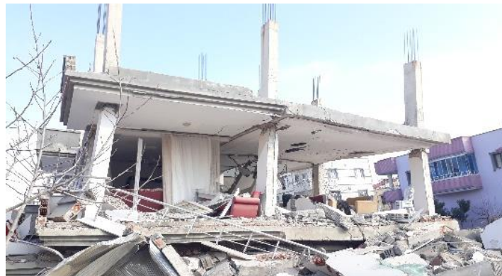
Şekil 73. Asmolen döşeme uygulamasının neden olduğu hasarlar
