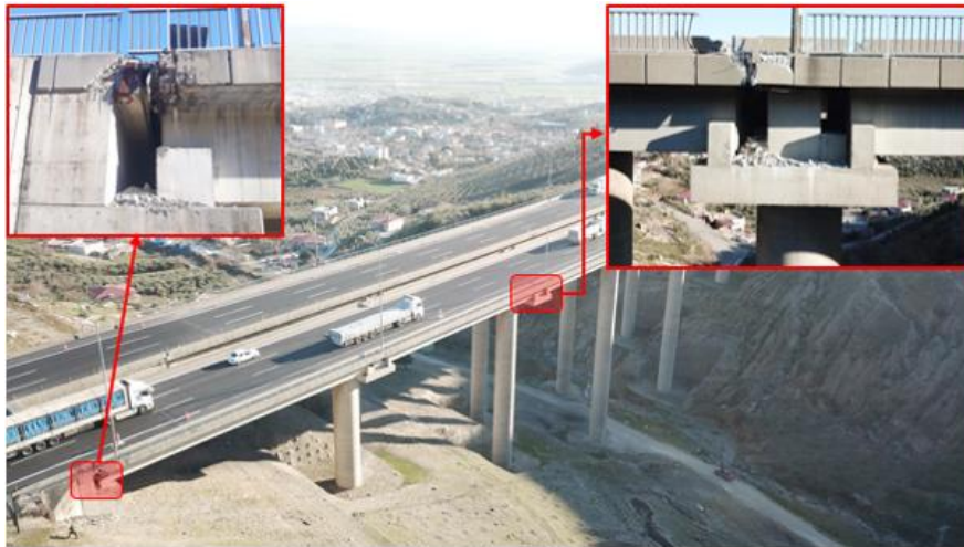
Şekil 114. Çekiçleme nedeniyle köprülerde oluşan hasarlara ait bazı örnekler
