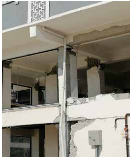
Şekil 75. Asmolen döşeme uygulamasının neden olduğu hasarlar
