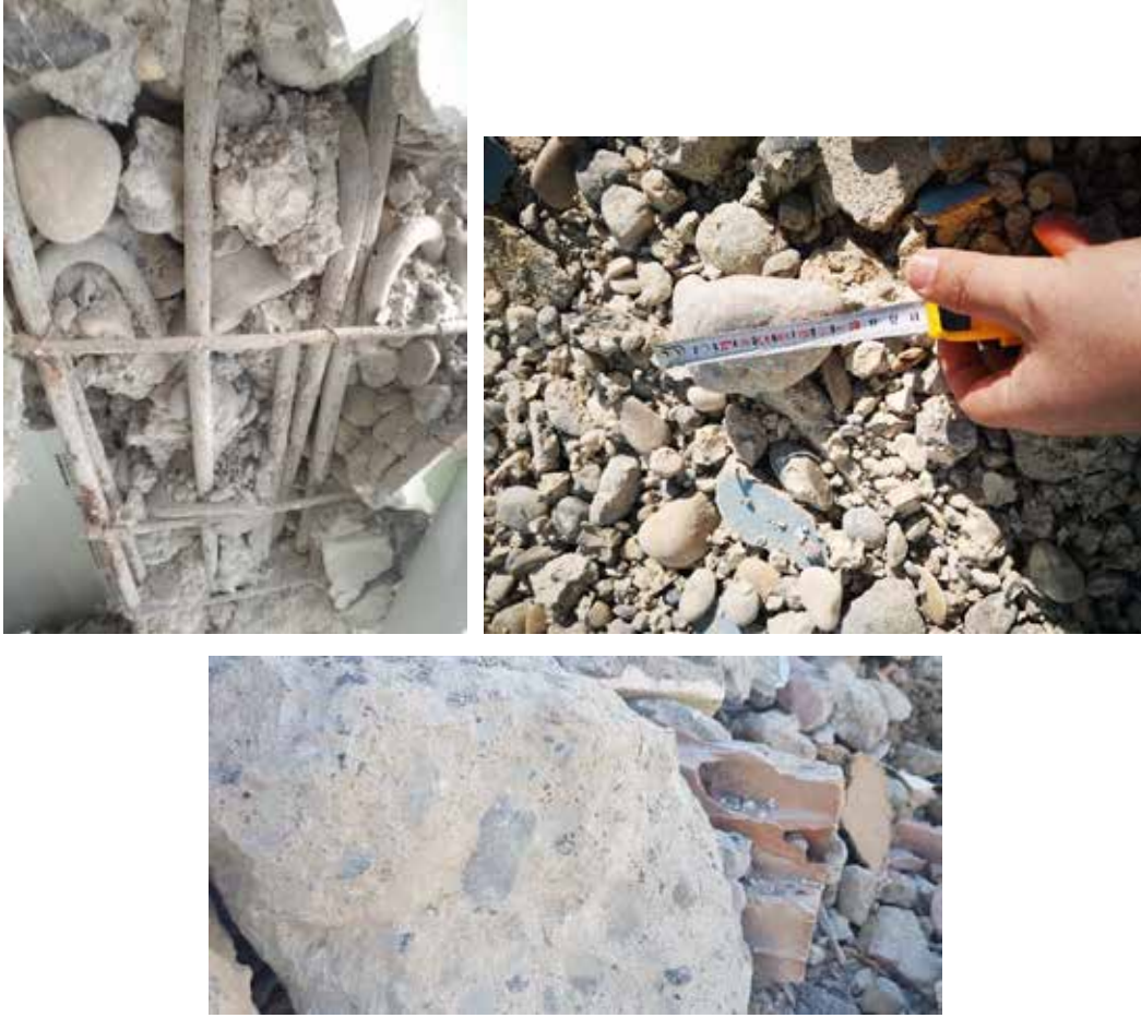
Şekil 78. Düşük beton kalitesine ait görseller
