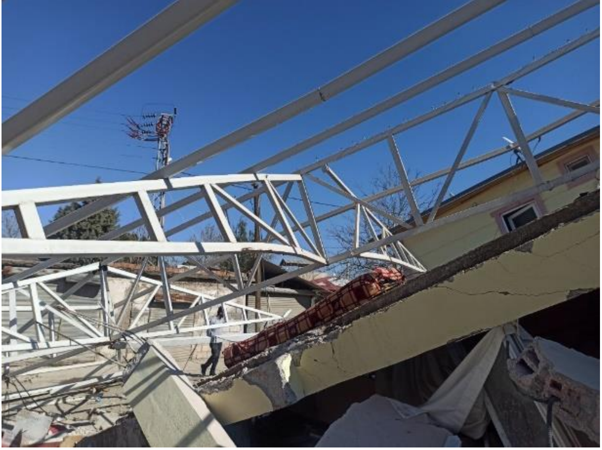
(a) Çelik çatı göçmesi
