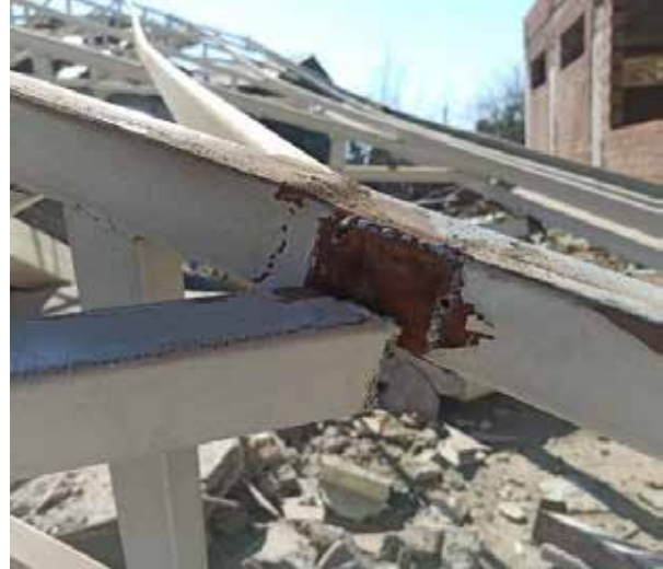
(c) Hatalı kaynak uygulaması ve korozyon
