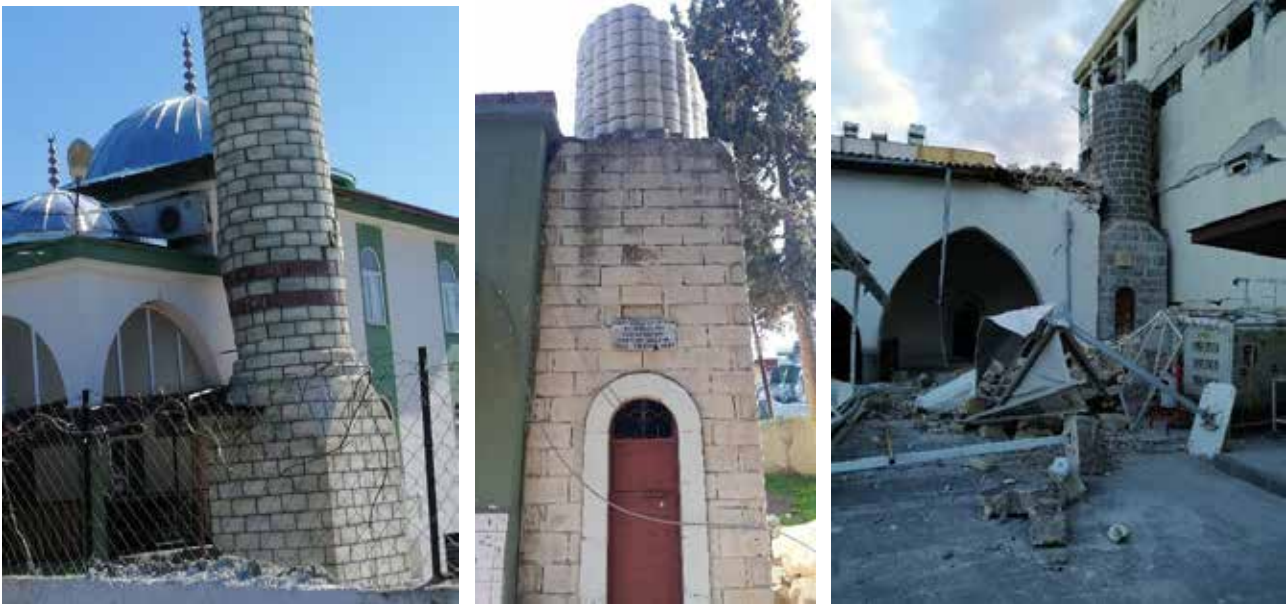
Şekil 185. Minare gövdesinde tespit edilen hasarlar
