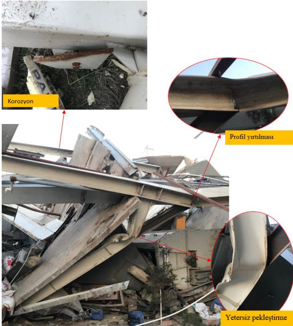
Şekil 102. Yıkılan bir çelik fabrikanın hasar incelemesi (Kahramanmaraş)
