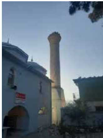
Şekil 187. Petek bölümünde tespit edilen hasarlar
