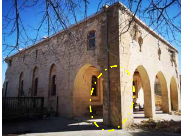
Şekil 135. Ayakta meydana gelen çatlaklar
